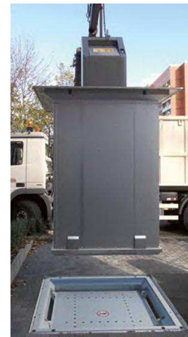
Geschlossene Sicherheitsplatte nach Anheben des Unterflurbehälters
